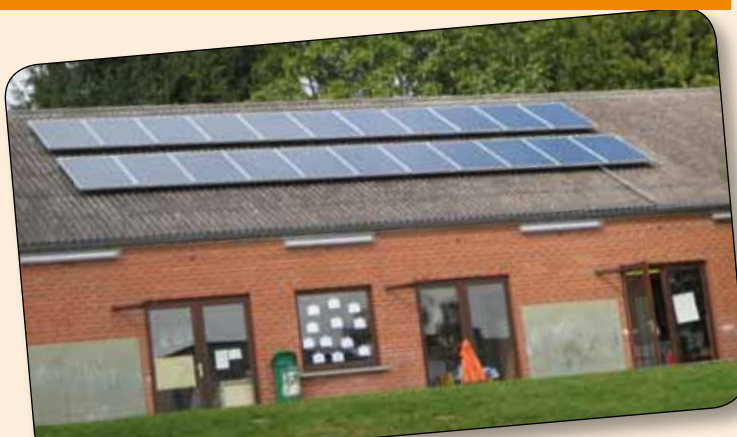
Panneaux photovoltaïques sur le toit de l'école communale
